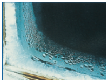
Kondenzace na okně může urychlit tvorbu plísní.
